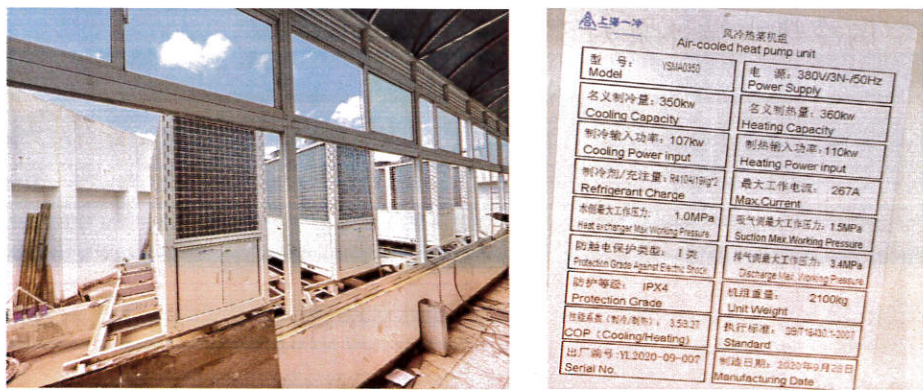
图 2.2-1 风冷热泵机组现场照片
