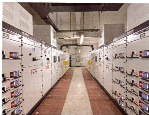
图 2.3.2-1 高压配电间现场照片
