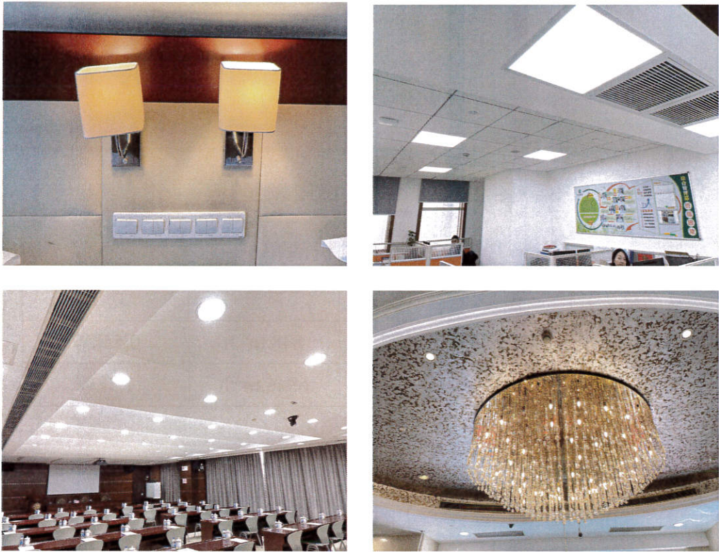
图 2.2-9 照明现场照片
