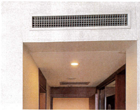
图 2.2-4 风机盘管出风口现场照片
