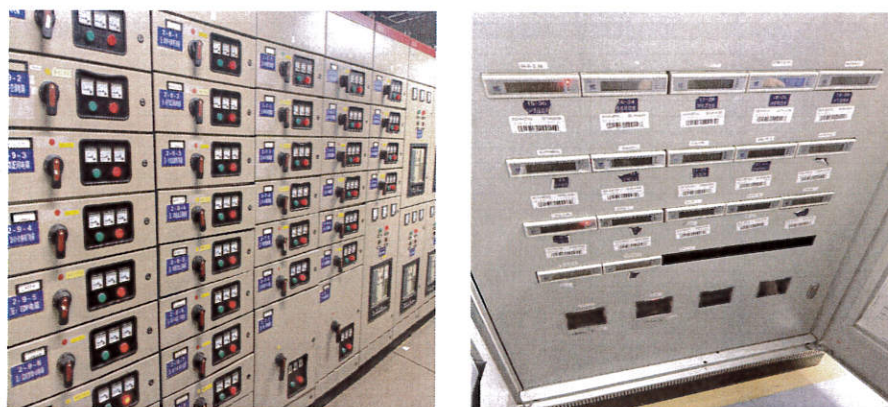
图 2.3.2-1 高压配电间现场照片
