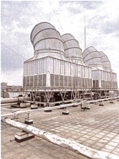
图 2.2-6 空调冷却塔现场照片
