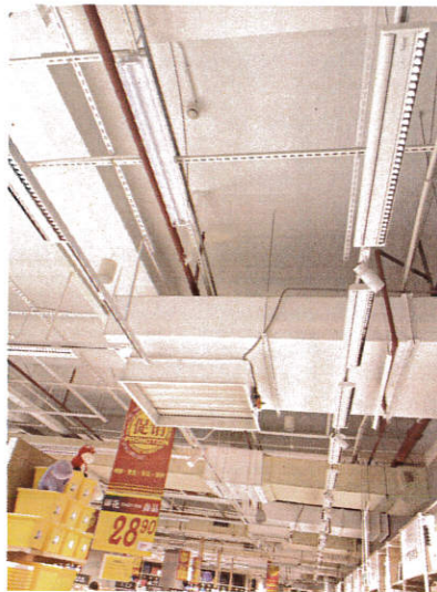
图 2.2-4 组合式空调箱送风口现场照片
