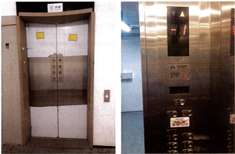
图 2.2-4 电梯现场照片
