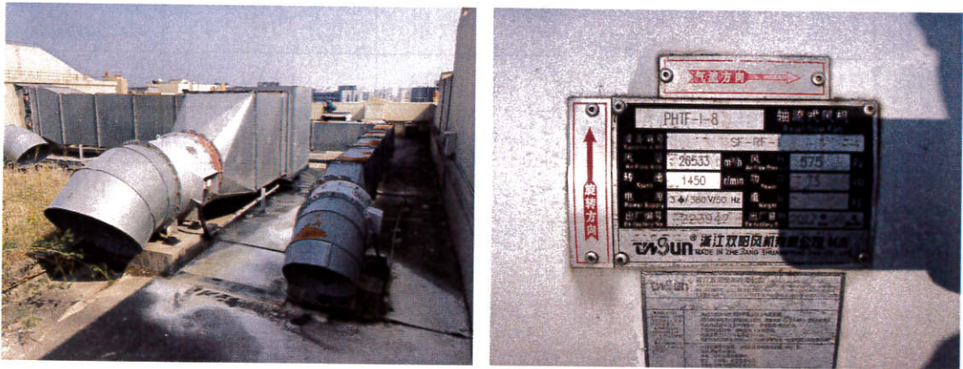
图 2.2-5 排风机现场照片
