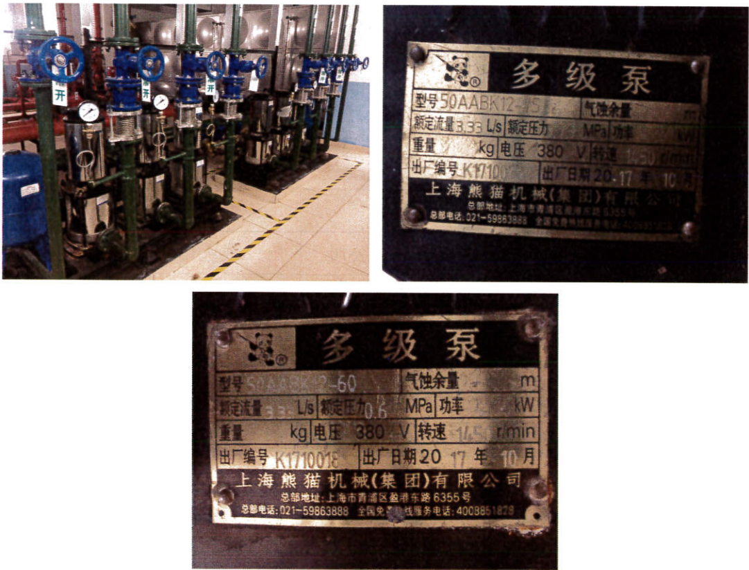
图 2.2-3 生活水泵现场照片
