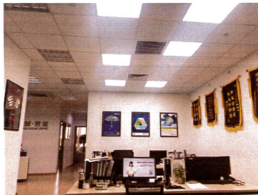
图 2.2-2 空调末端出风口现场照片
