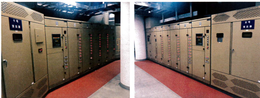
图 2.3.2-1 高压配电间现场照片
