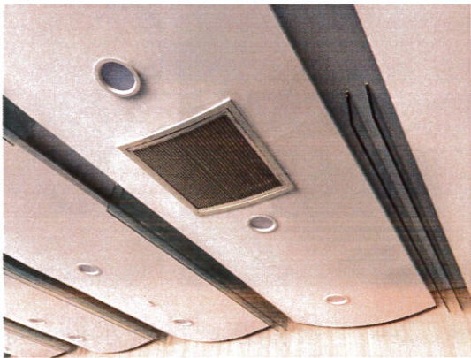
图 2.2-6 风机盘管出风口现场照片
