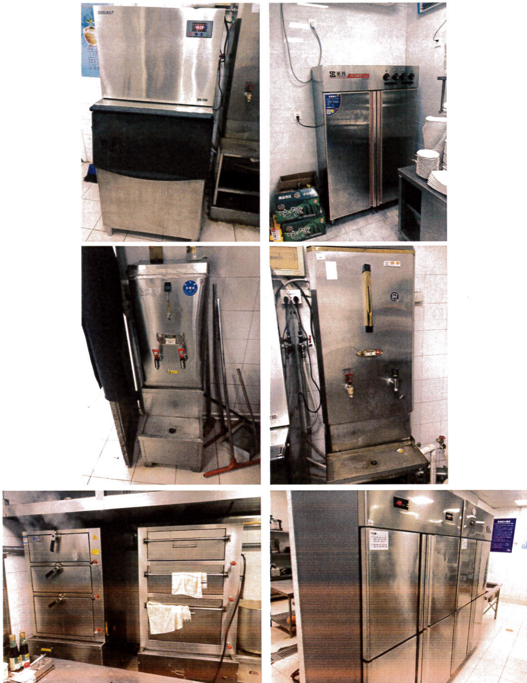
图 2.2-11 冰柜、制冰机、洗碗机现场照片
