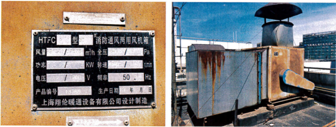
图 2.2-9 排风机现场照片
