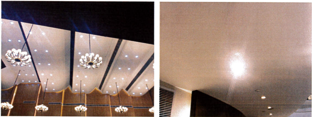
图 2.2-10 照明现场照片
