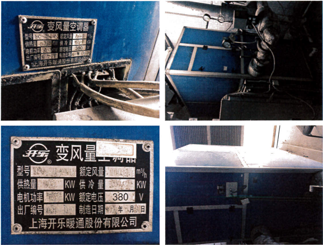
图 2.2-5 空调设备现场照片
