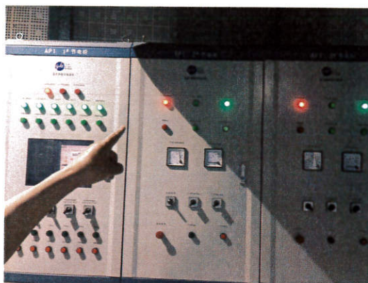
图 2.3.3-2 变频器现场照片
