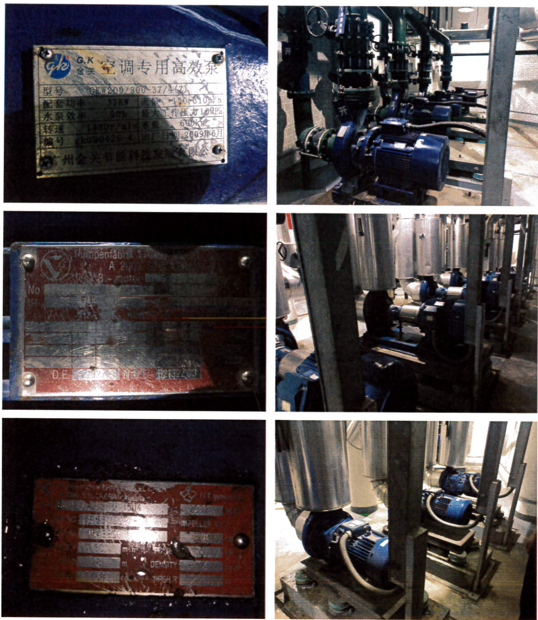
图 2.2-4 冷热水、冷却水循环泵现场照片
