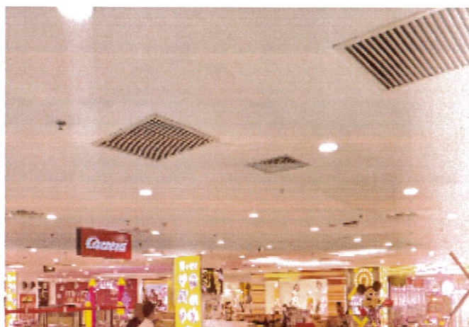
图 2.2-5 风机盘管出风口现场照片
