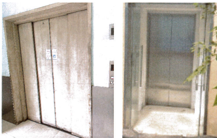
图 2.2-9 电梯现场照片
