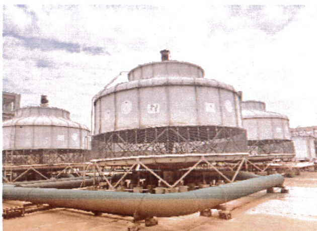
图 2.2-7 空调冷却塔现场照片
