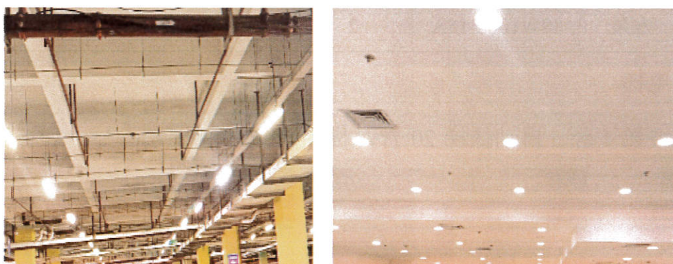
图 2.2-10 照明现场照片
