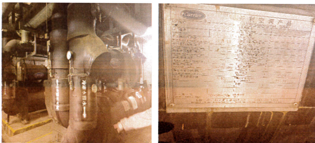
图 2.2-1 离心式水冷机组现场照片
