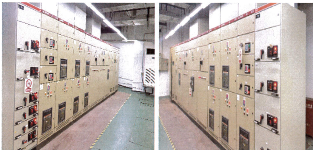
图 2.3.2-1 高压配电间现场照片
