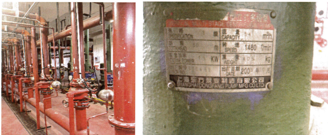
图 2.2-8 生活水泵现场照片
