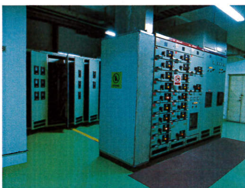
图 2.3-3 高压配电间现场照片
