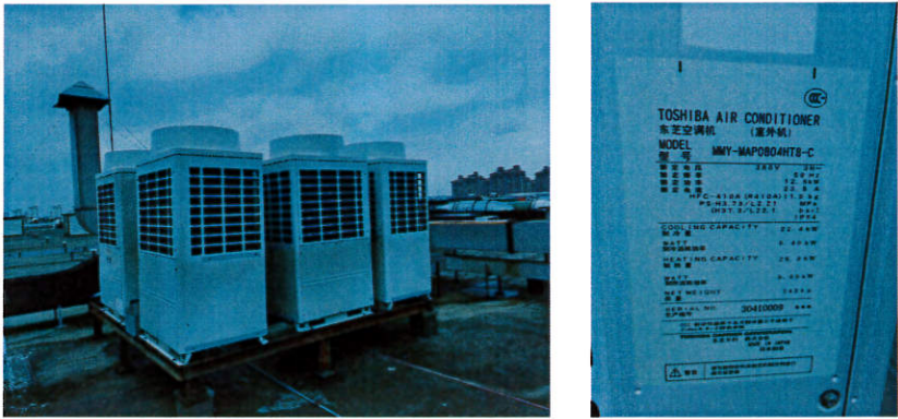
图 2.2-2 多联机室外机现场照片
