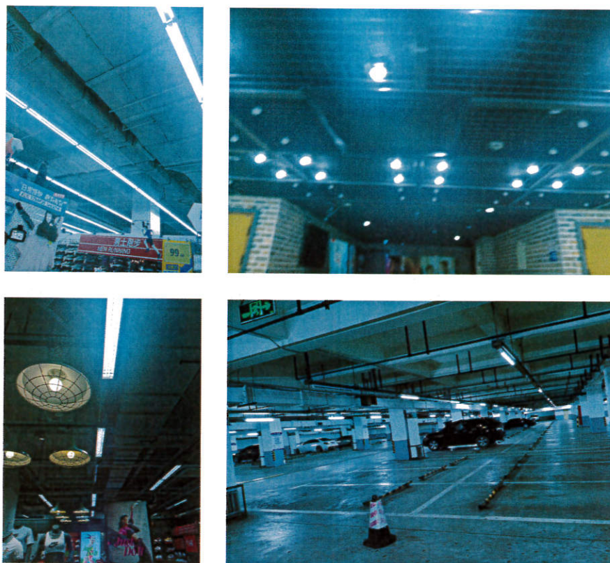
图 2.2-7 照明现场照片
