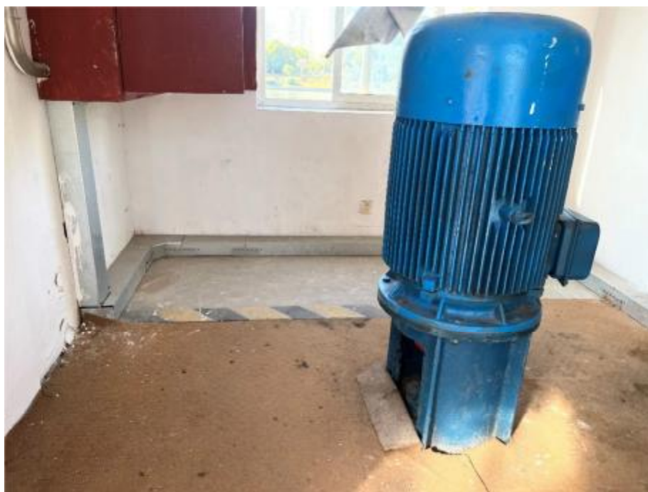
图 1.5-14 现状照片 4（水泵电机）
