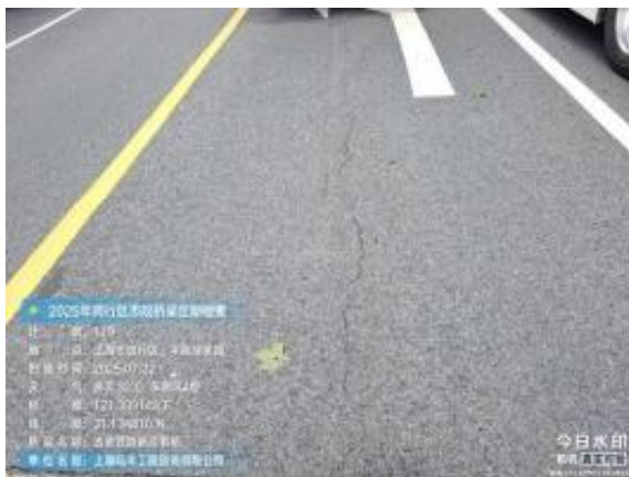
车行道沥青铺装裂缝
