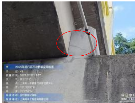
盖梁挡块斜向开裂
