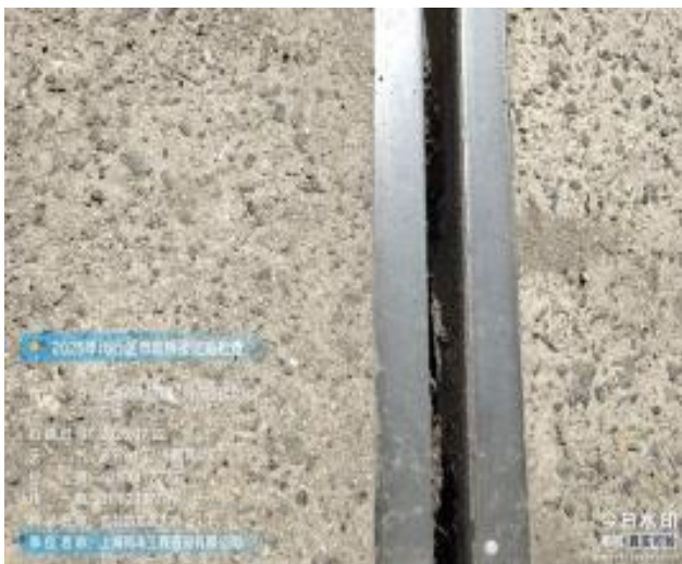
伸缩缝橡胶条破损
