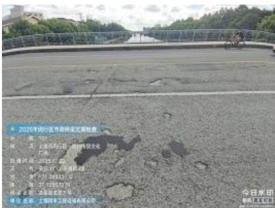
车行道沥青铺装坑槽
