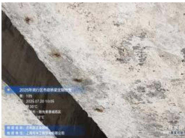
梁底破损露筋
