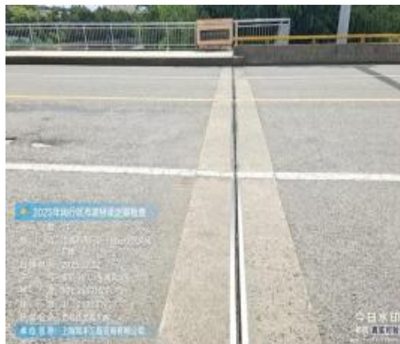
伸缩缝泥沙堵塞
