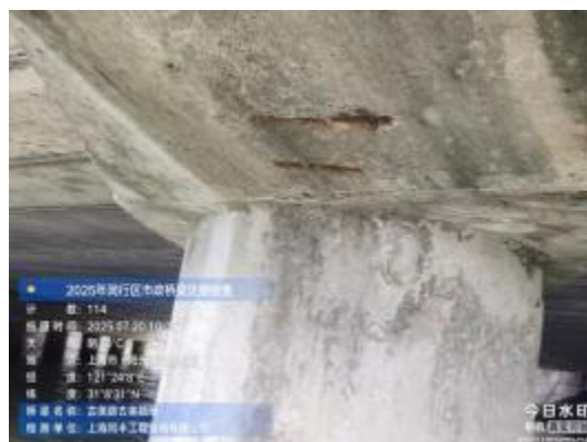
盖梁破损露筋
