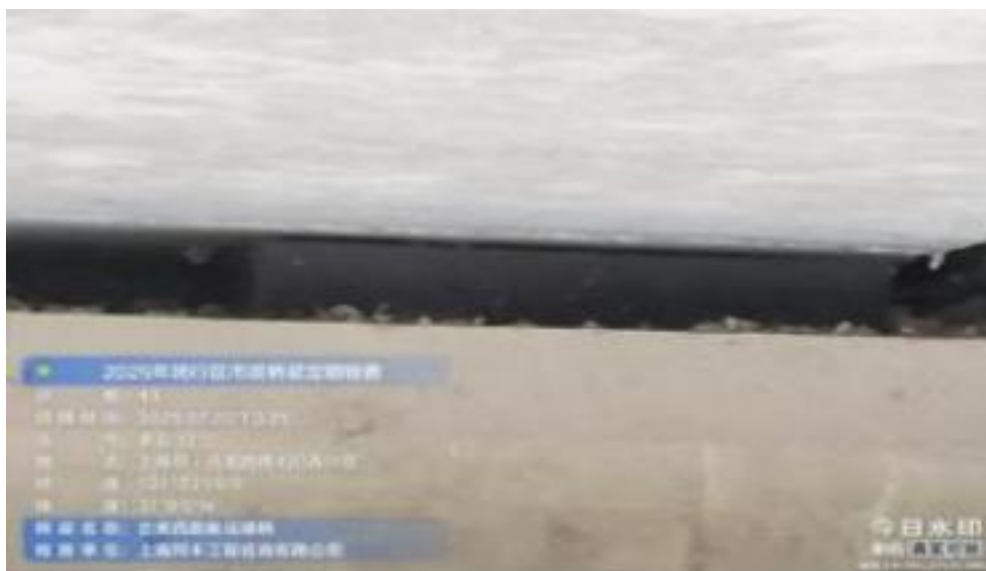
支座上部脱空
