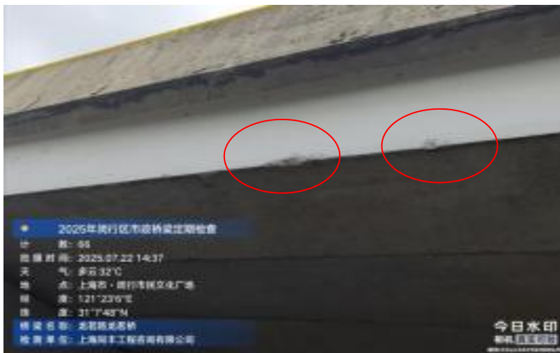
梁底破损掉角
