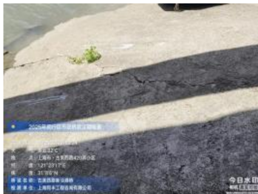
护坡坡面开裂
