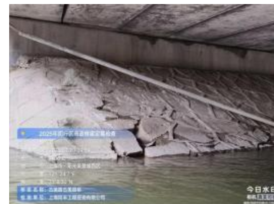
台前护坡塌陷
