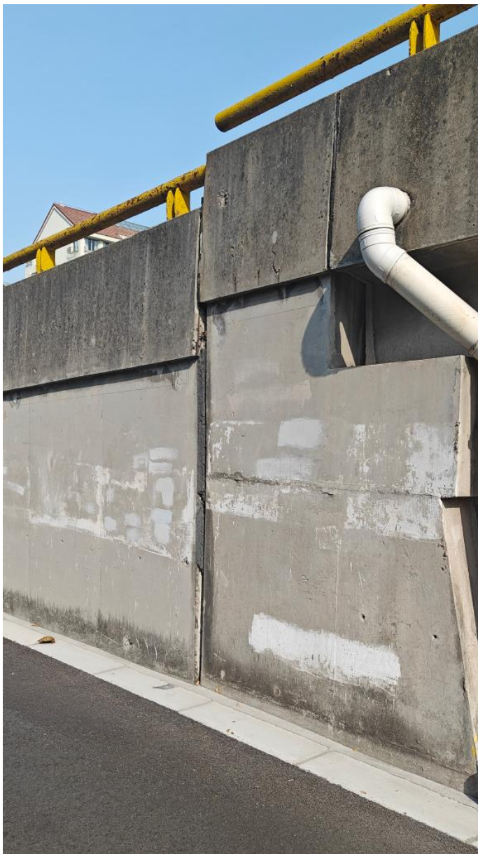
龙茗路龙茗大桥引道桥头 沉降明显
