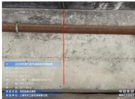
台身竖向裂缝
