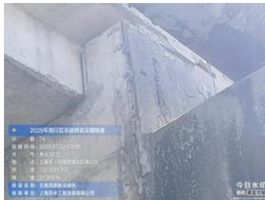
盖梁破损露筋
